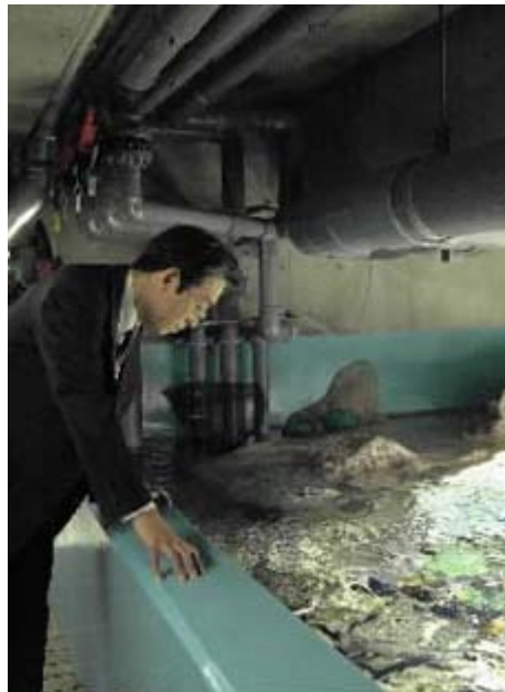
配管がめぐる海響館の舞台裏を見回る樋口さん。水槽の 反対側の見学者から姿は見えない＝下関市立水族館海 響館で
